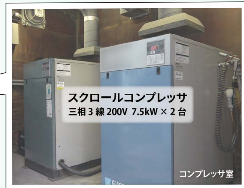
稼働中の既設コンプレッサを計測
