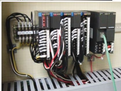
図3 Q棟電源室に設置された リモート I/O R3 シリーズ
