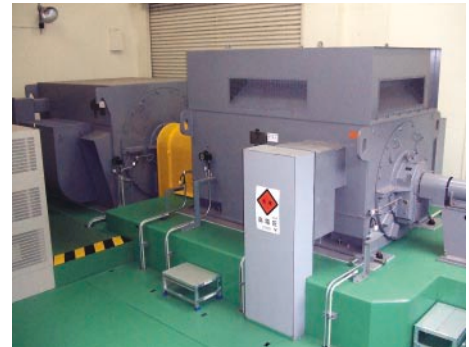
図2 電源設備(MGセット)
