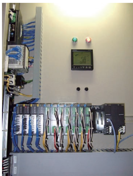
図3 盤内に設置されたリモートI/O
