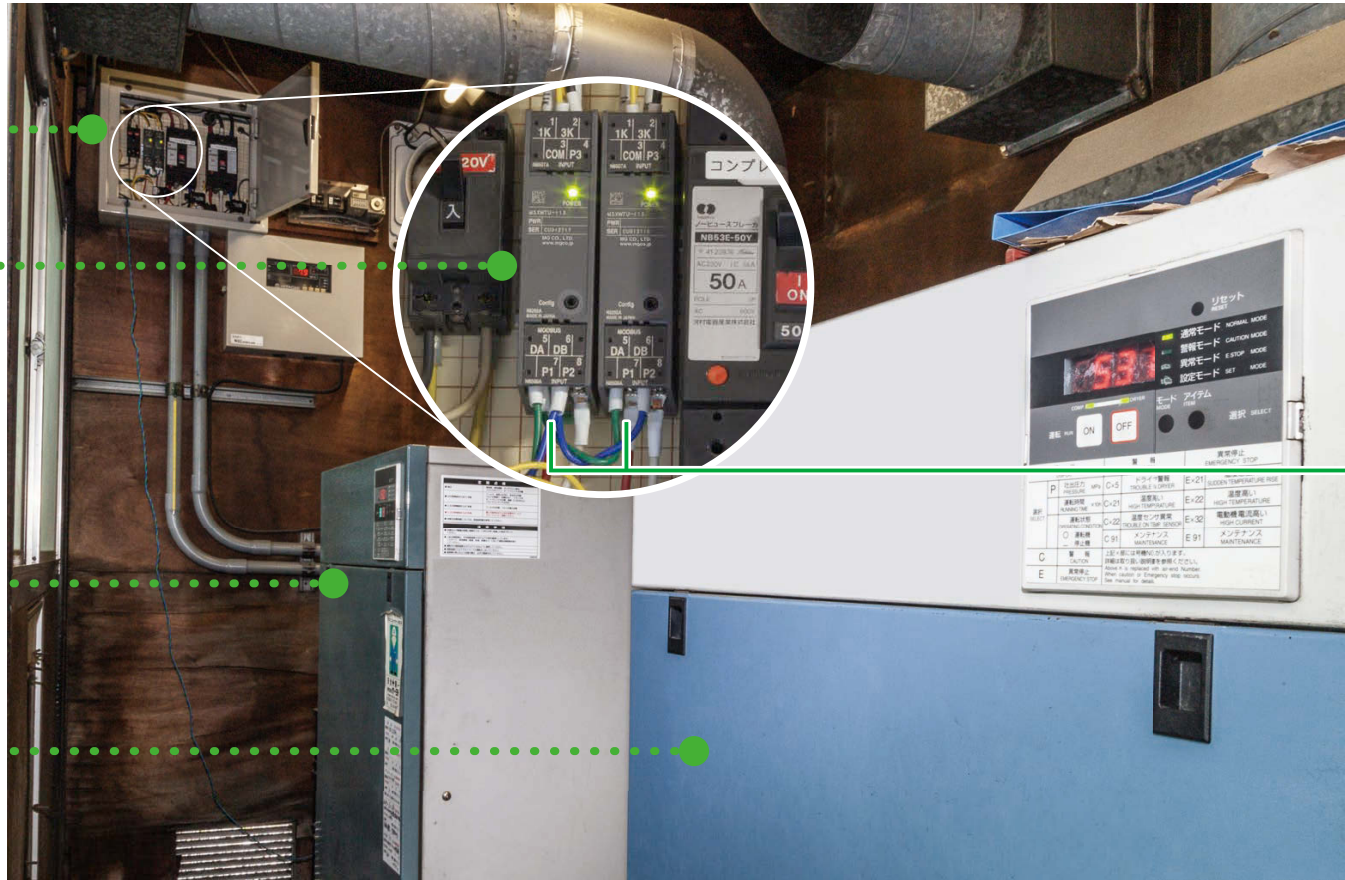
当社、大阪商品センター(工場)のコンプレッサ室
