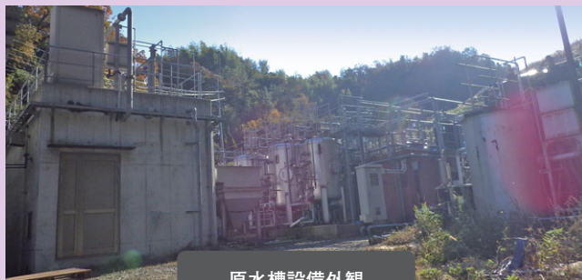
原水槽設備外観
