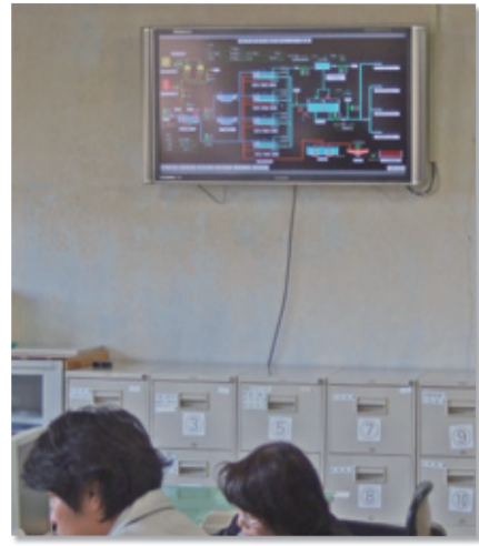
図4 市庁舎の水道課事務所に設置された大形液晶表示モニタ
