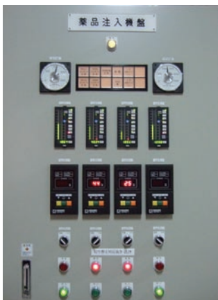
図3 薬品注入機盤
