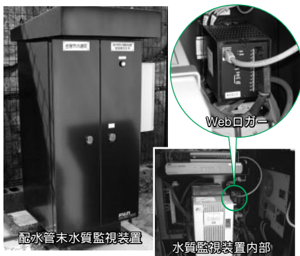
図2 配水管末水質監視装置
